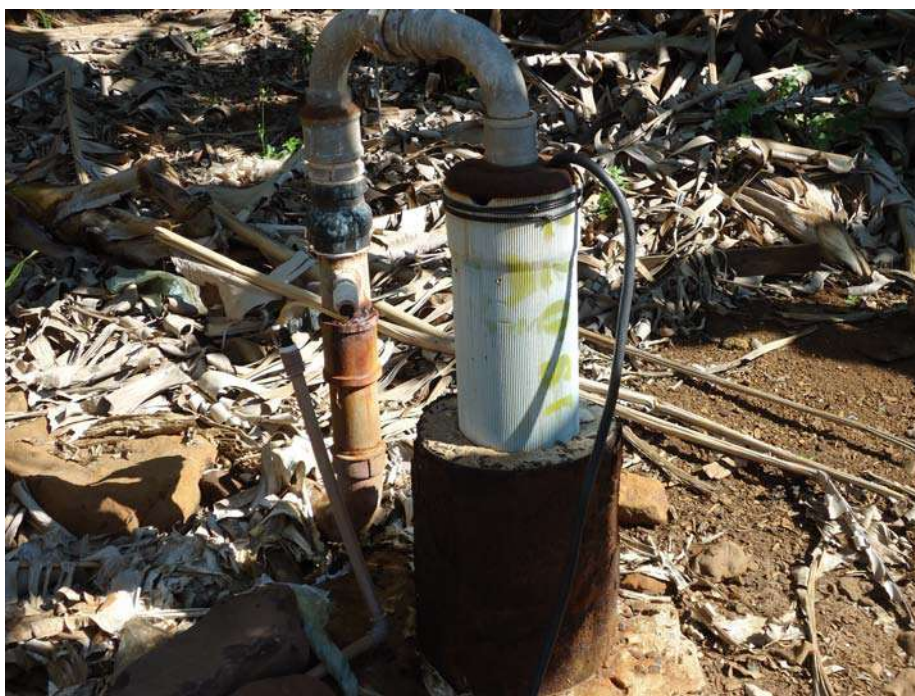
FOTOS 01 e 02- Poço tubular e casa de máquinas (FOTO: DIEGO RAUPP)
