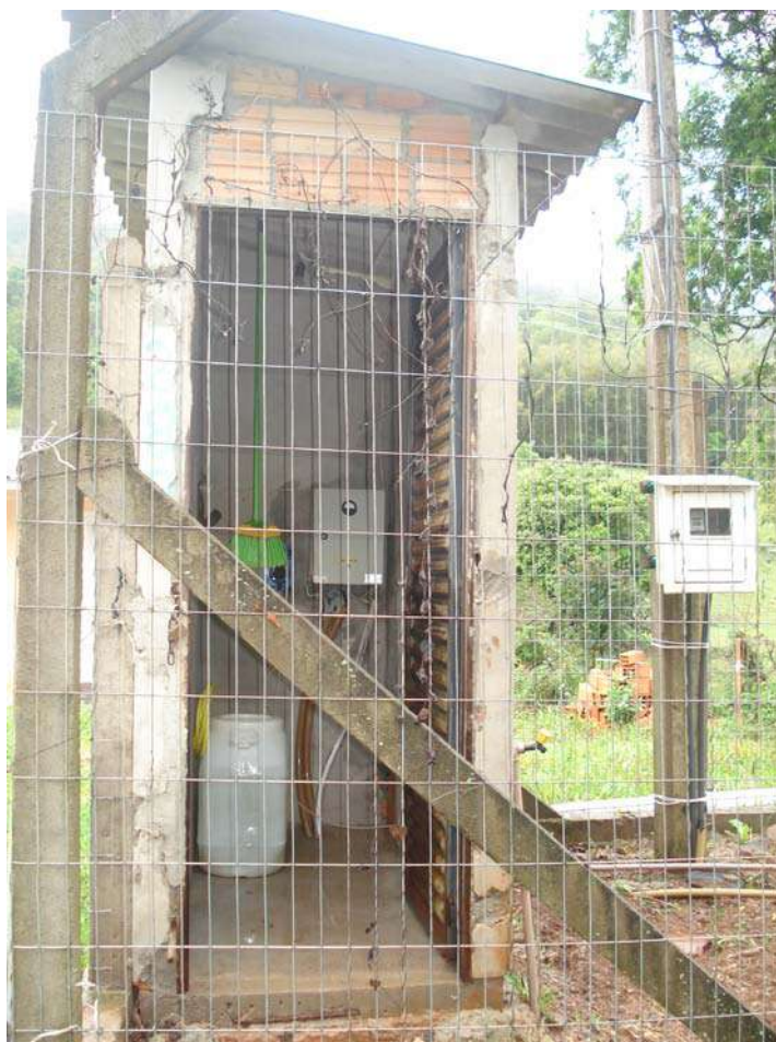
FOTO 04 - CASA DE MAQUINAS E POÇO (FOTO: SERGIO PINTO)
